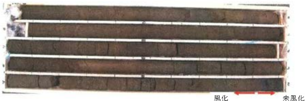
図 3.3-8 No.6 ボーリングコアの深度 5m~10m 間。砂岩部分は風化し深度 10m 付近の泥岩層以深で未風化帯に移行する。
