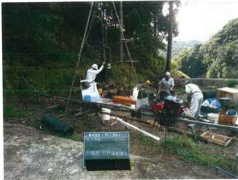
第Ⅲ-1埋立地調査ボーリング No. 7付近 掘進（試料採取）状況
