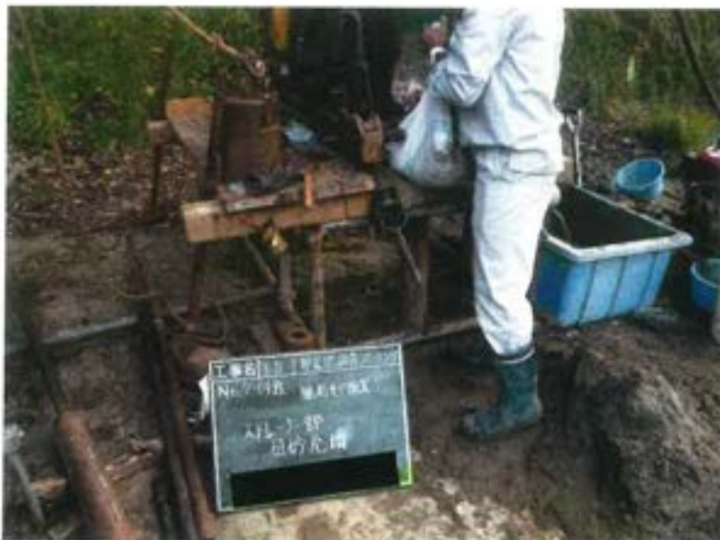
第Ⅲ-1埋立地調査ボーリング No. 7付近 観測井戸設置 有孔管部 珪砂充填
