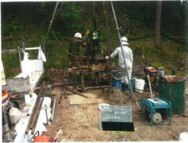
第Ⅲ-1埋立地調査ボーリング No. 7付近 観測井戸設置 孔内スライム除去
