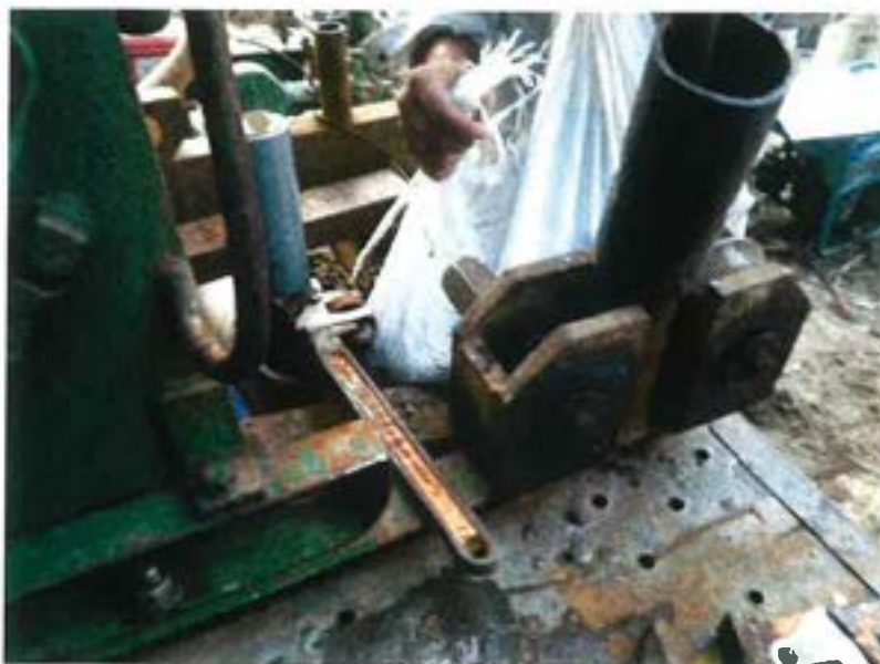
第Ⅲ-1埋立地調査ボーリング No. 7付近 観測井戸設置 珪砂充填
